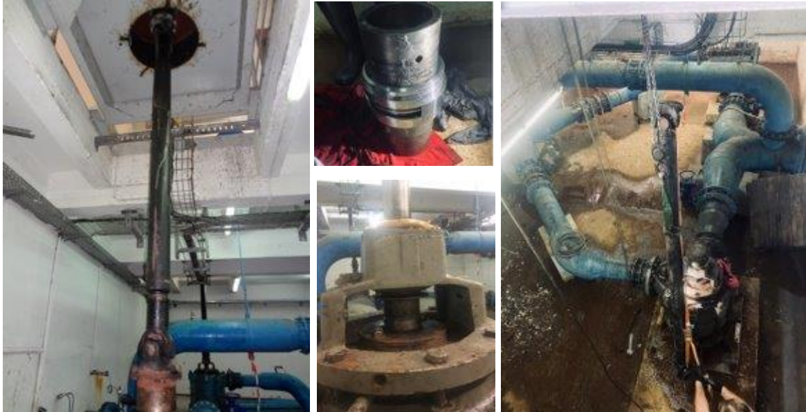
Photos : pièces d'usures remplacées sur les pompes de Terrasson
